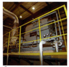
7 蒸気タービン発電機
