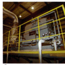
7 蒸気タービン発電機
